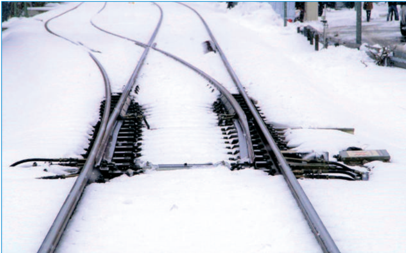
Die geothermische Weichenheizung im Betrieb. Copyright: GRETA-Projekt ■
