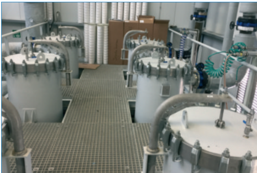
Abb. 6: Filtertribüne im Heizwerk mit den Kerzenfiltern.
