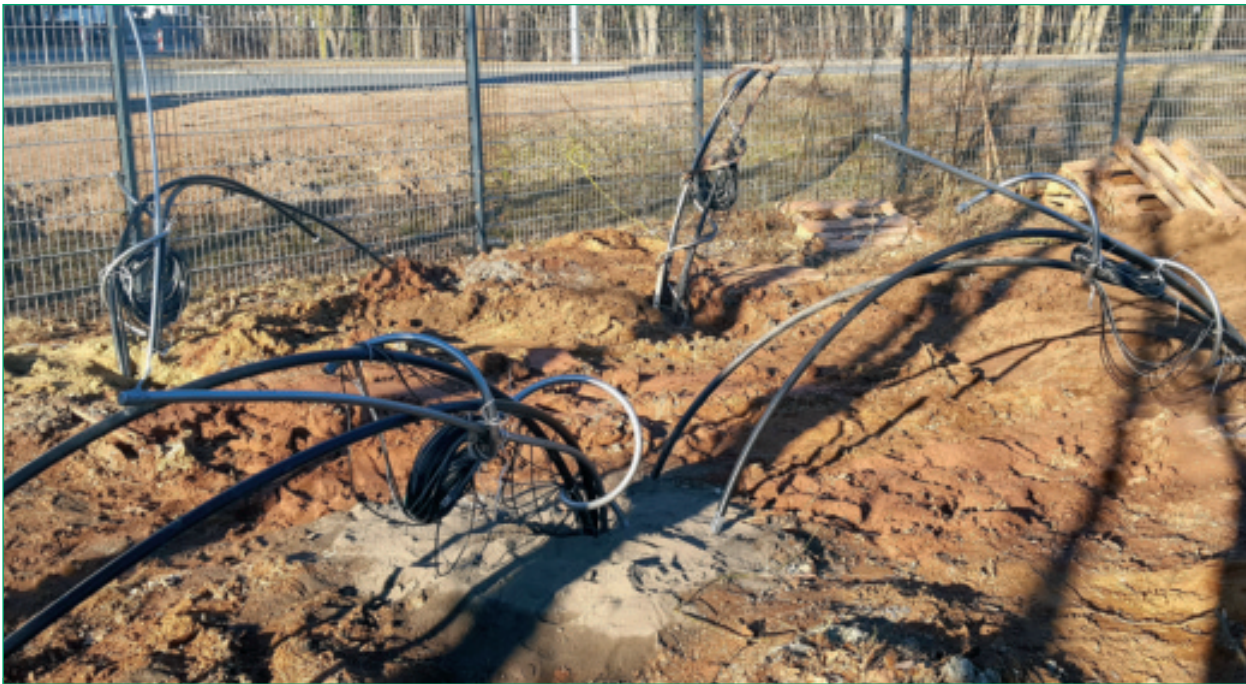
Testfeld des Projektes "Cheap-GSHPs" in Erlangen-Eltersdorf ■
