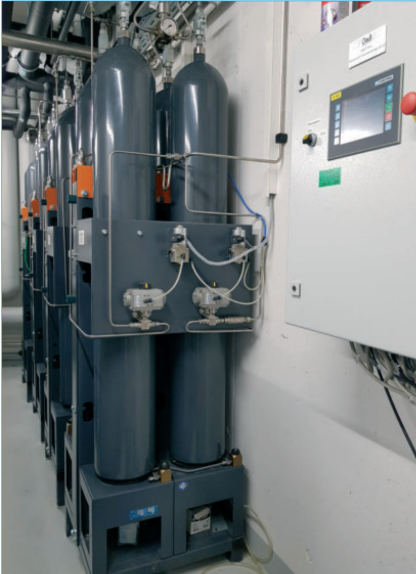
Die Magnetventile der Speicherbänke werden über B-CONTROL angesteuert und ermöglichen so vollautomatischen Betrieb. ■
