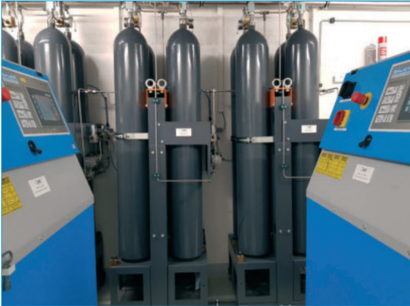
Ein redundantes System von zwei VERTICUS Verdichtern sorgt für Produktionssicherheit. ■
