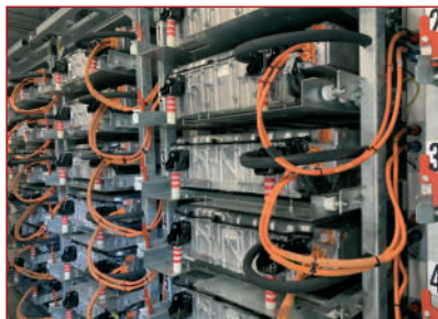
In Wendelstein sorgt ein neuartiger Batteriespeicher für die Stabilisierung des Stromnetzes. Im Rahmen des Projekts arbeiten Fachleute aus Energieunternehmen, dem Anlagenbau und der Automobilbranche zusammen. Auf technisches Neuland haben sich die Experten gegeben, um die aus Elektroautos von Audi stammenden Batteriesysteme mit der bereits bestehenden Sicherheitshülle in eine stationäre Einheit zu integrieren und zu verschalten. Zwei vollklimatisierte Container mit einer Grundfläche von rund 75 Quadratmetern beherbergen die 84 Batterien. ■
